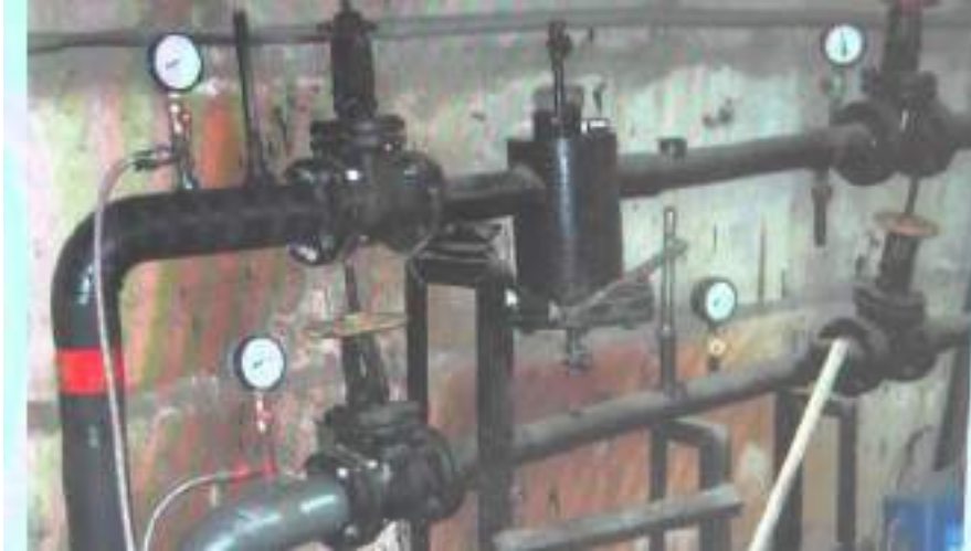
Рис. 1 Тепловий пункт громадської будівлі
